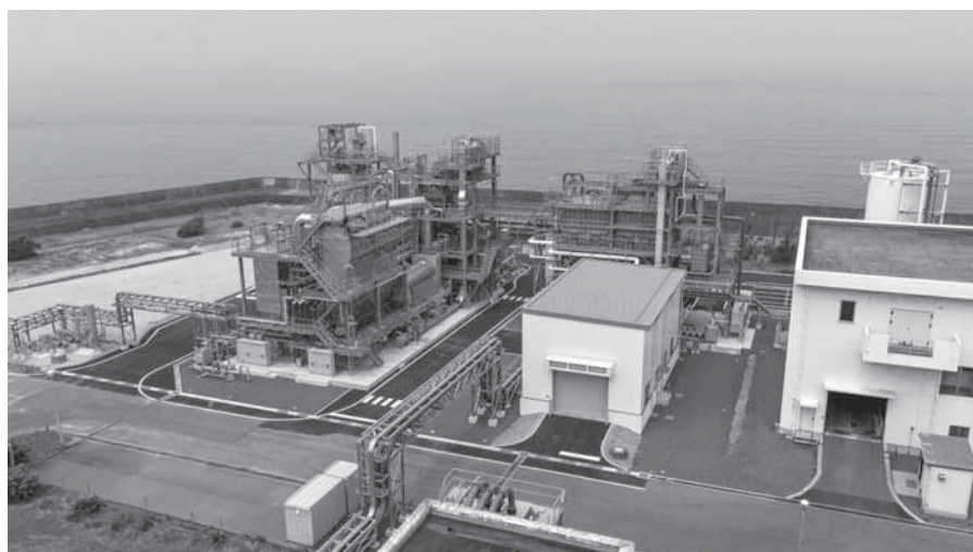
松山市に竣工した下水汚泥固形燃料化施設
